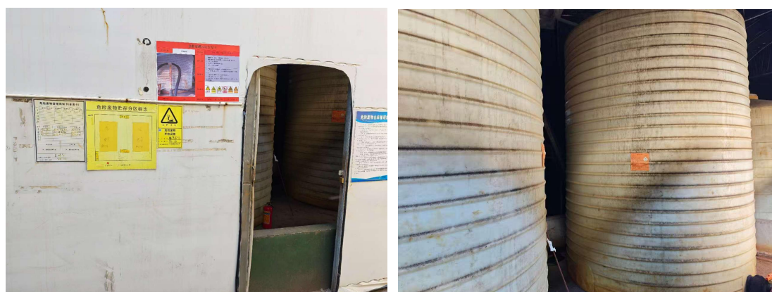
图 4-6 部分危废仓库设施图
