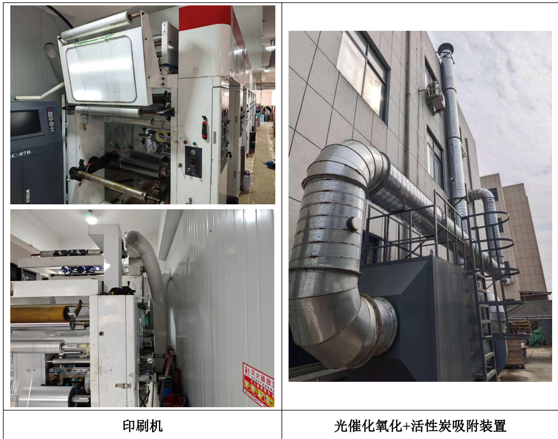
图 4-3 部分废气处理设施图
