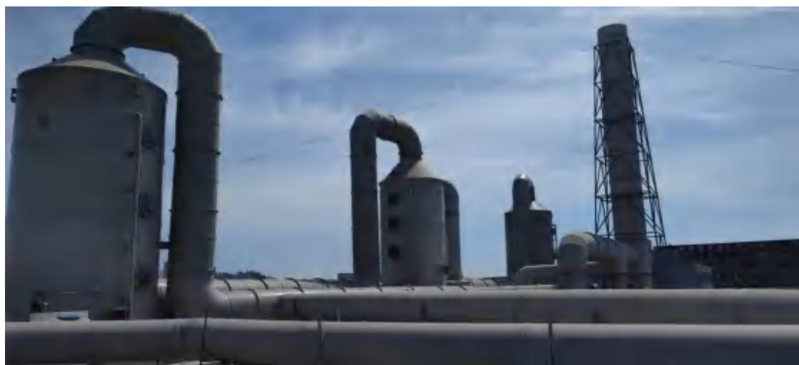
图 4-4 废气处理设施图
