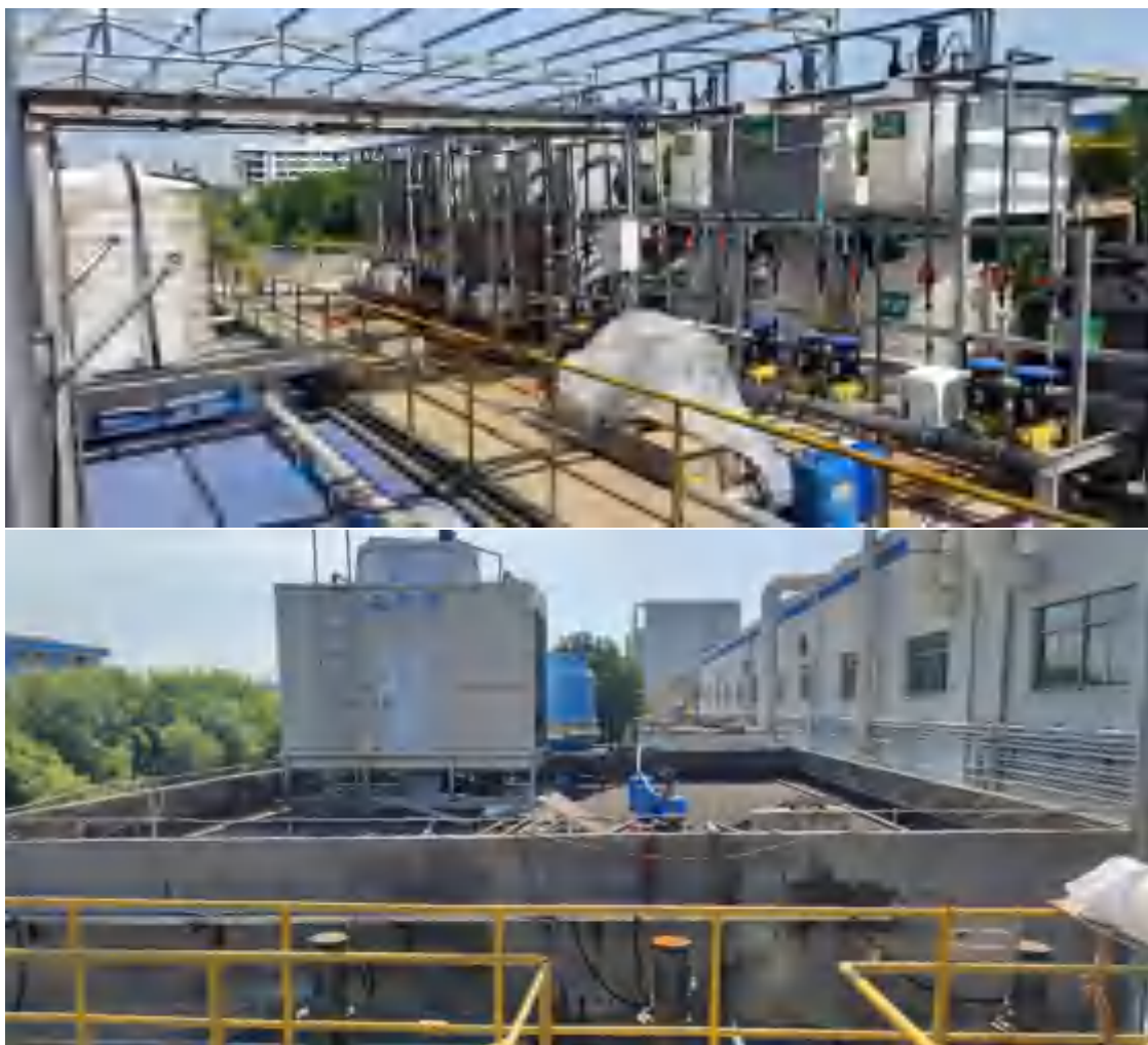
图 4-2 企业污水处理站
