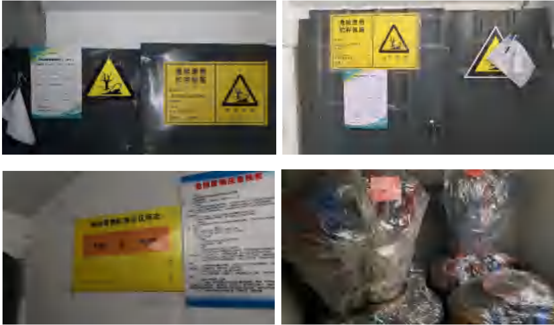
图 4-4 部分危废仓库设施图
