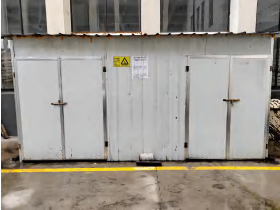
图 4-3 部分危废仓库设施图
