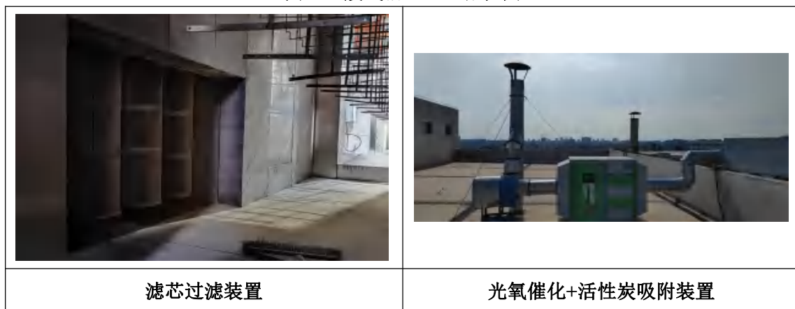
图 4-4 部分废气处理设施图
