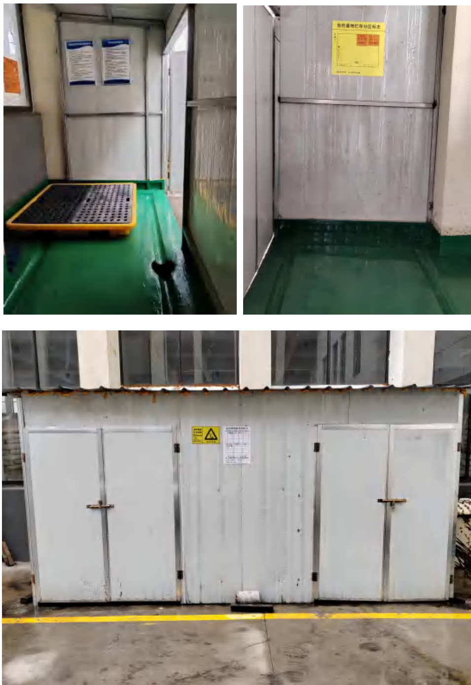
图 4-4 部分危废仓库设施图
