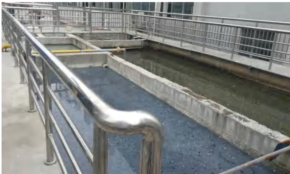
图 4-2 部分废水处理设施图
