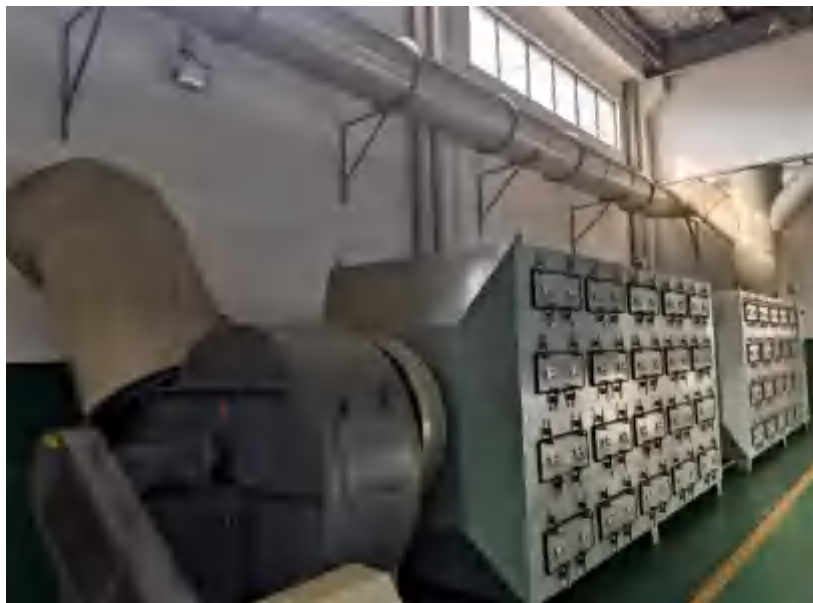
图 4-3 部分废气处理设施图
