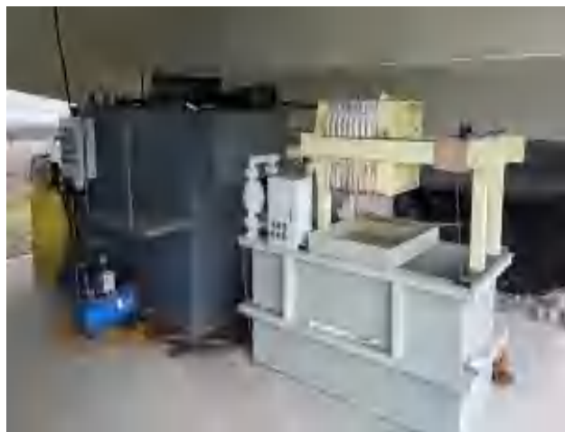
废水处理设施
