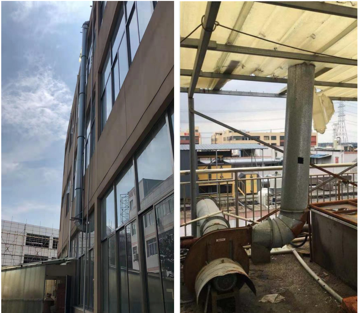
图 4-3 部分废气处理设施图
