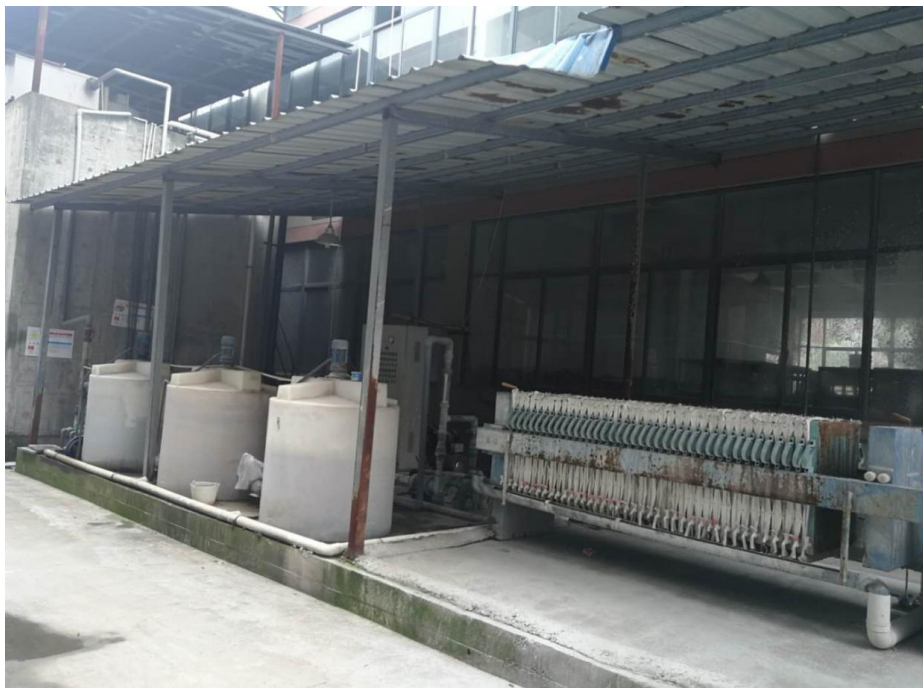
图 4-2 部分废水处理设施图
