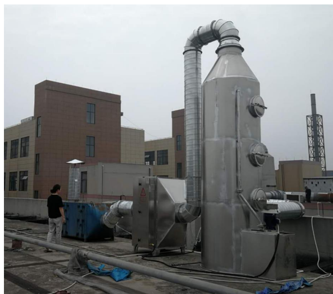
北车间坯料生产废气处理设施
