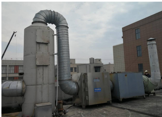
南车间坯料生产废气处理设施
