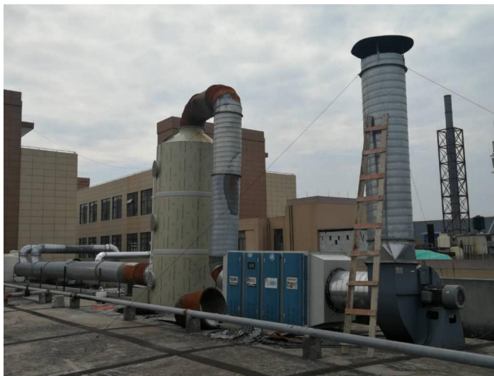
喷漆废气处理设施
