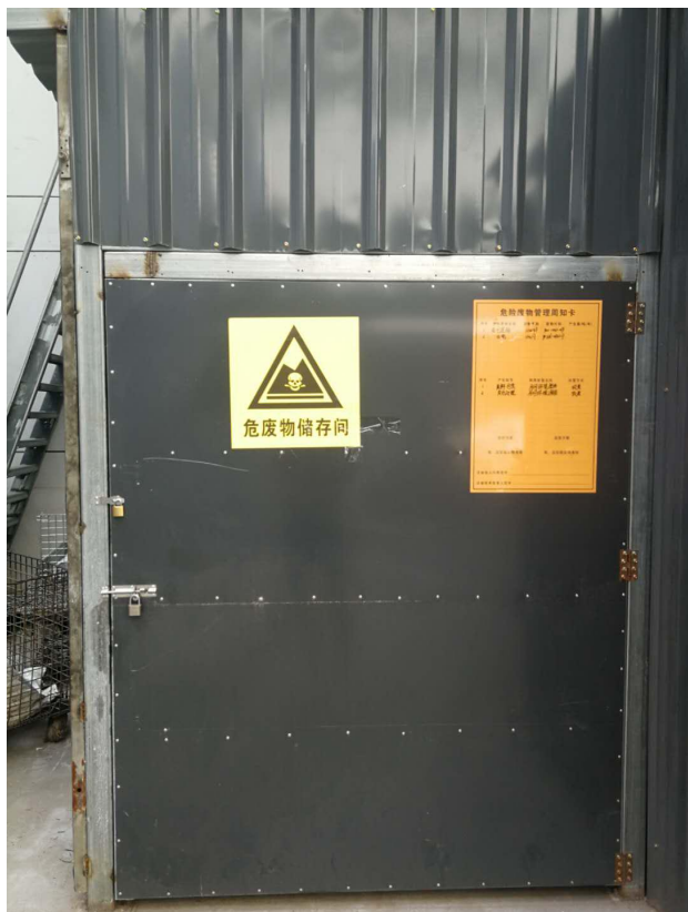
附件 10 危废仓库建设图片
